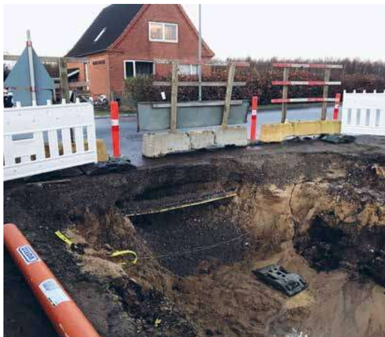
Udgravning væsentligt dybere end en meter helt op til kørebane kant. Der er anvendt betonklodser som afskærmning, og trafikken er dermed ikke sikret imod at køre ned i udgravningen.
